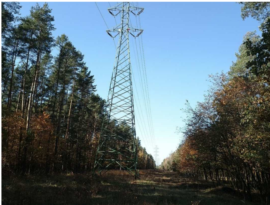
Ryc. 10 Linia elektroenergetyczna wysokiego napięcia 110 kV Ozimek – Zawadzkie
